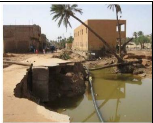
Figure I.10. Montrant l'ampleur des dégâts de l'inondation du Ghardaïa en octobre 2008 [source Google]
