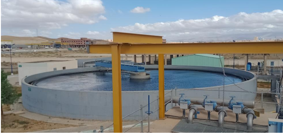
Figure 19: décantation secondaire STEP Sidi Aissa
