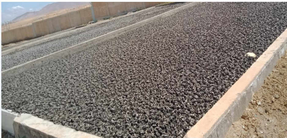
Figure 20: lits de séchage des boues STEP Sidi Aissa
