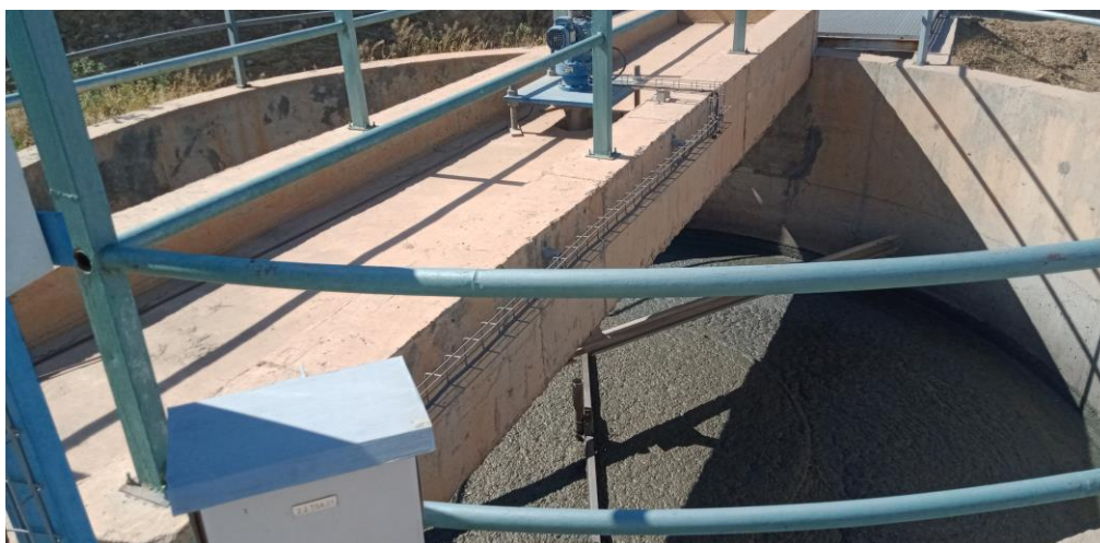
Figure 17: Dessablage, Dégraissage STEP Sidi Aissa
