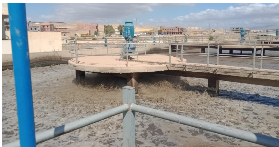
Figure 18 : Bassin d'aération STEP Sidi Aissa
