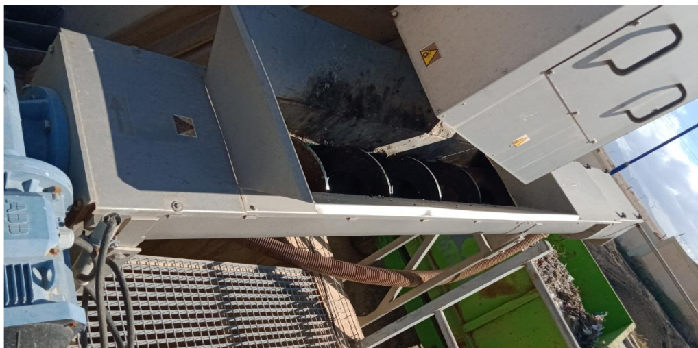
Figure 16: Dégrillage STEP Sidi Aissa
