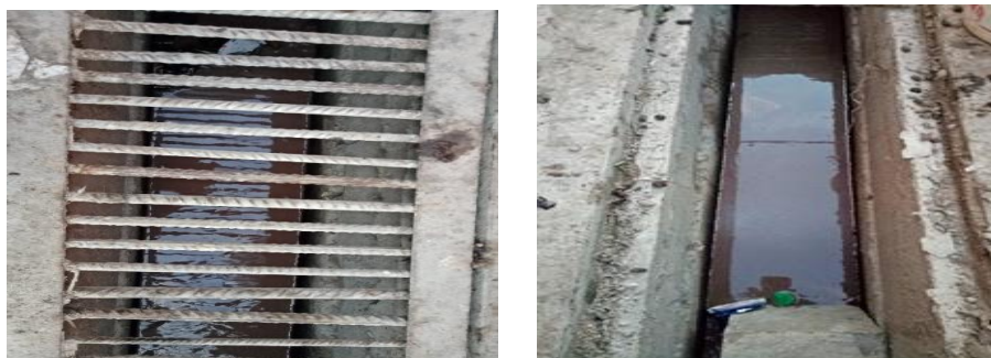
Figure I.10 : Rejet des margines vers le réseau d'égout
