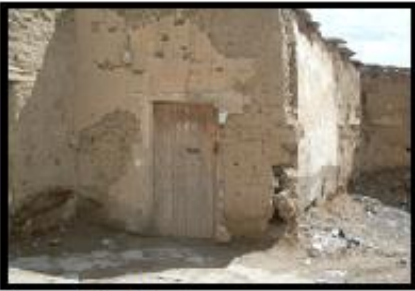
Source :Etudiants Fig 83 :Constructionen mauvais état
