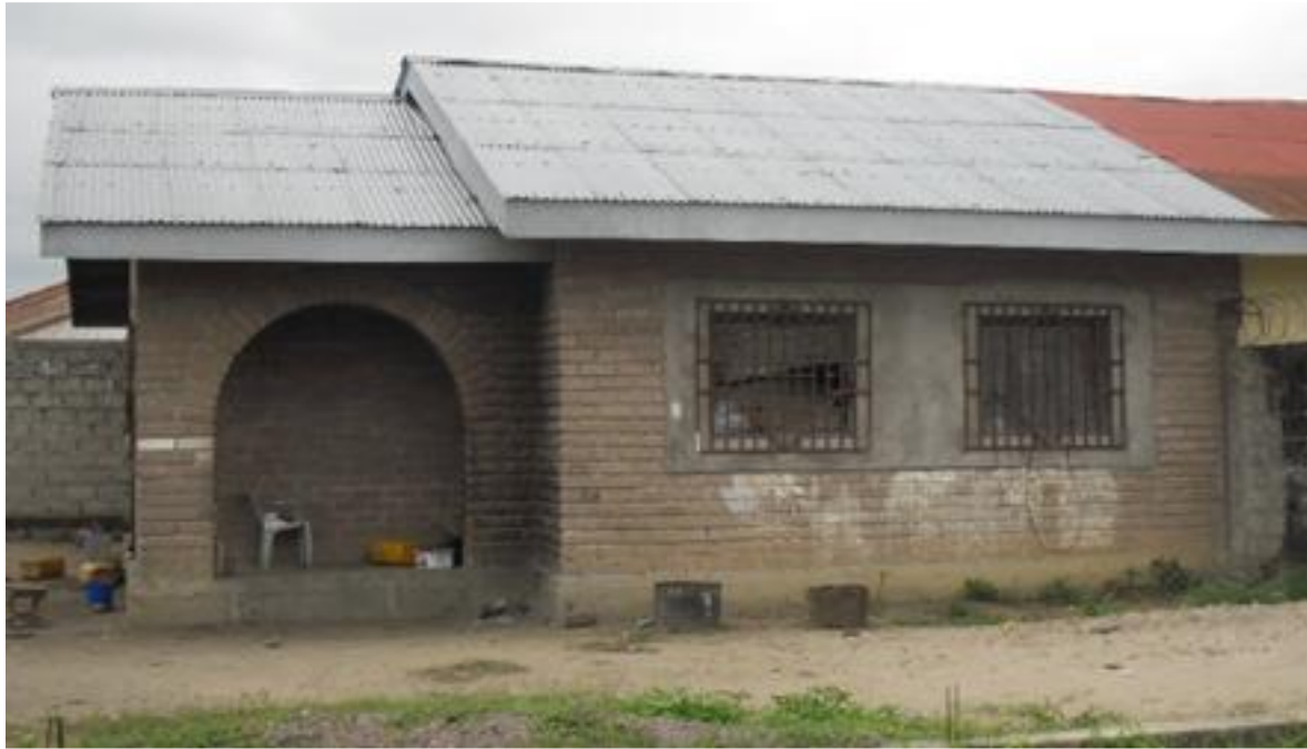
Fig. Problèmes d'usure et d'émiettement des briques sur façades extérieures d'une bâtisse en terre stabilisée à Brazzaville (construite en 1997)
