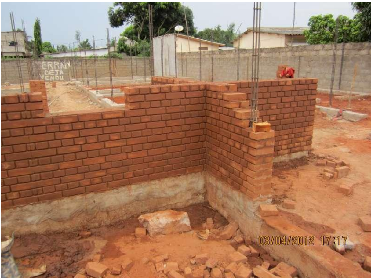
Fig2 :étude de cas :Mise en pratique de la construction en terre crue ( https://www.google.com/search?q=historique+sur+mortier+de+terre&client=fir )
