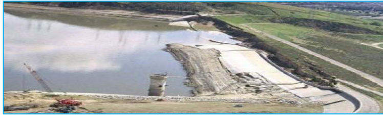
Figure I. 20 Rupture par liquéfaction
