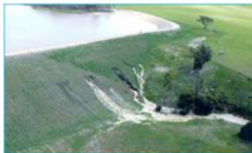
Figure I. 14 Rupture par affouillement
