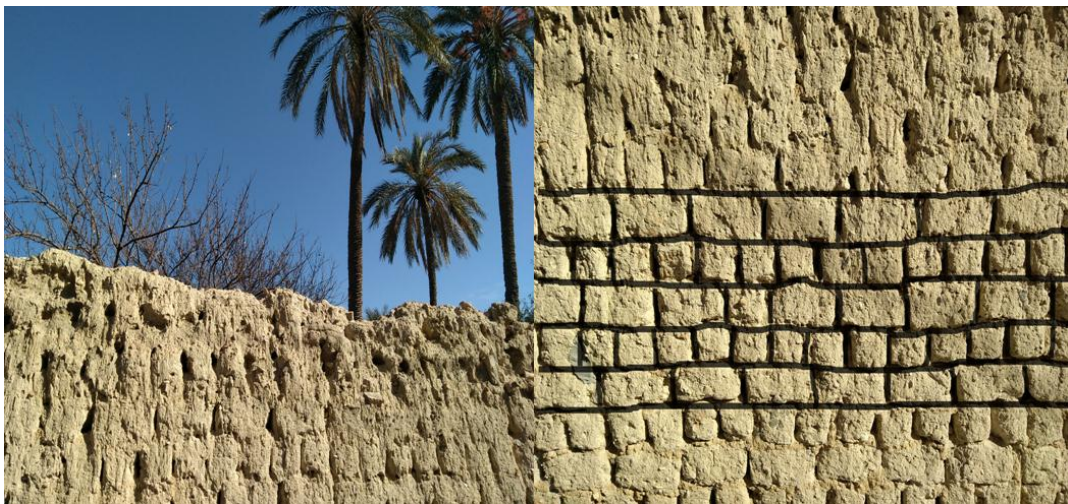
Photo.2.15: Mur d'un parc dans la ville de Bou-saâda (Photo : SAADAOUI Benaceur OUAHAB Yamina).
