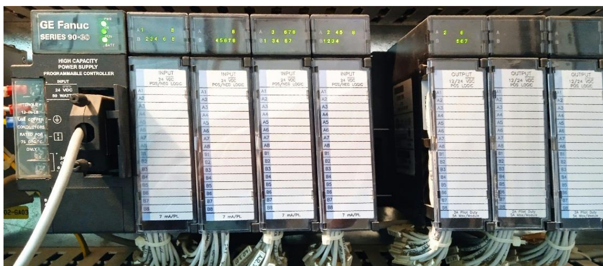
Figure II.10 : Photo réelle du PLC prise sur site
