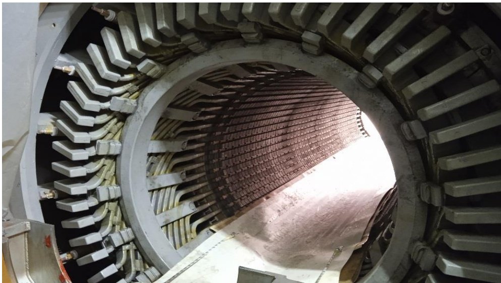
Figure I.7 : Photo réelle de l'enroulement stator d'un alternateur Ansaldo prise sur site
