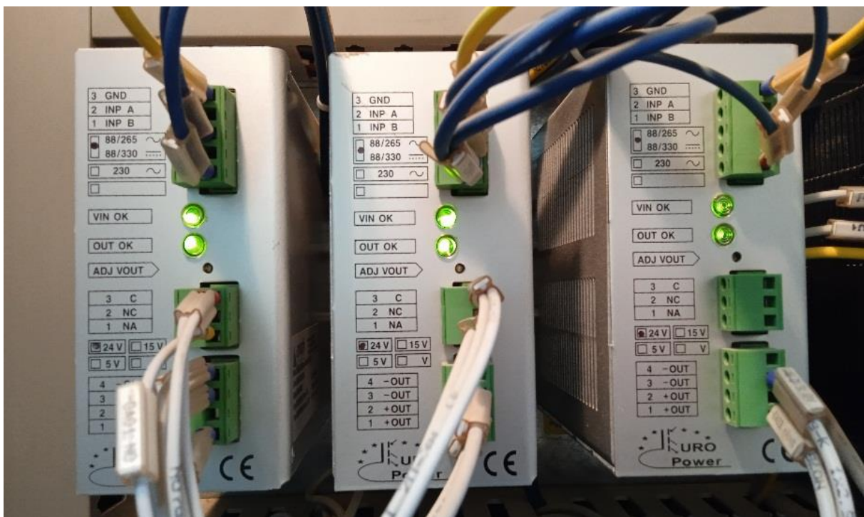
Figure II.8 : Photo réelle du box panier prise sur site
