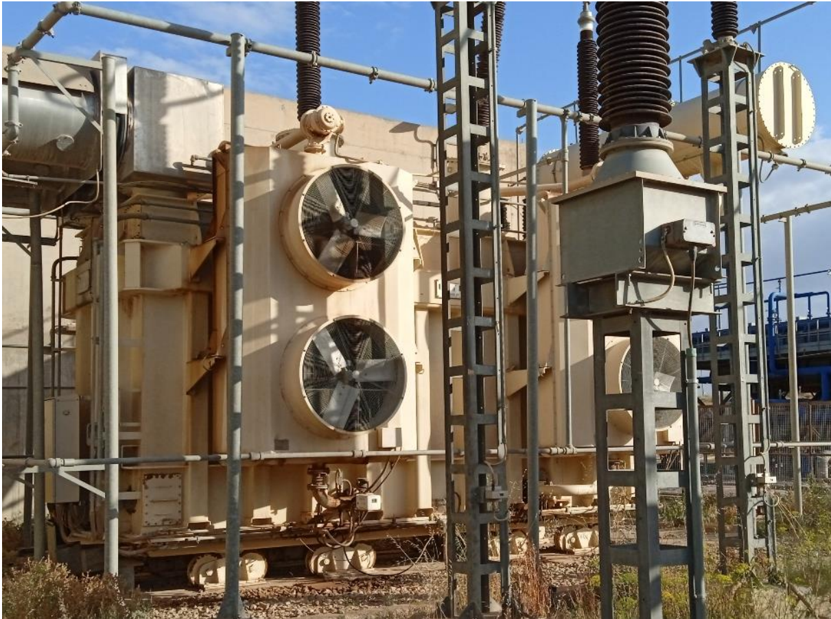
Figure I.10 : Photo réelle du transformateur de puissance prise sur site
