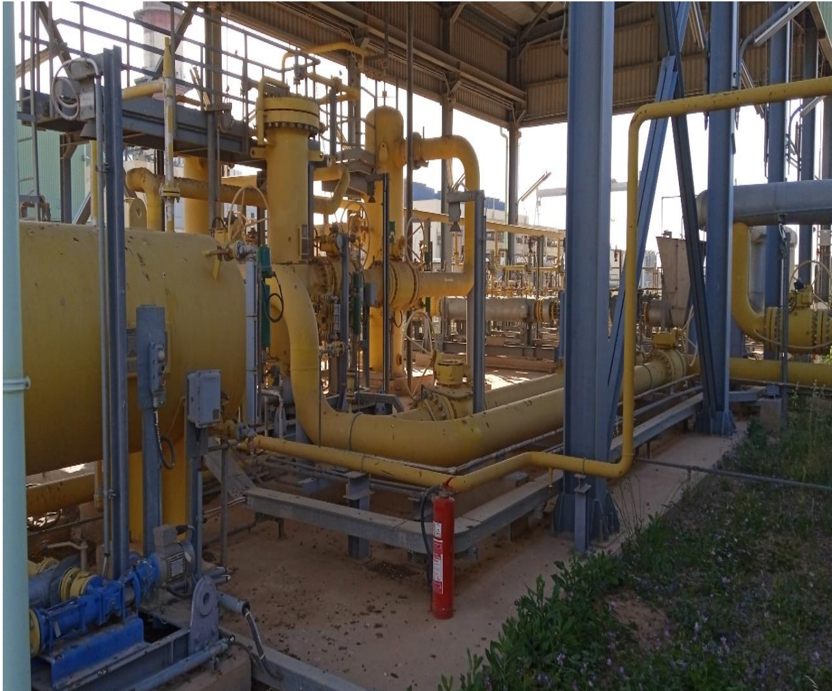
Figure I.2 : Photo réelle du poste gaz prise sur site
