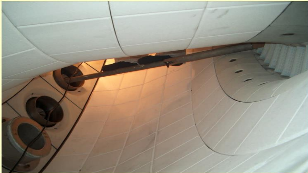
Figure I.4 : Photo réelle de la chambre de combustion de type annulaire prise sur site
