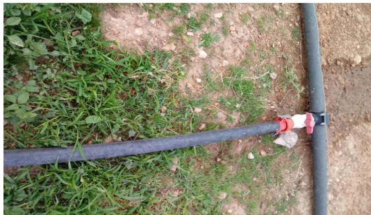
Figure 18A ; Té-vanne sur conduite en pvc
