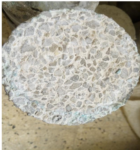
Figure IV-11: Détérioration du béton a l'œil nu
