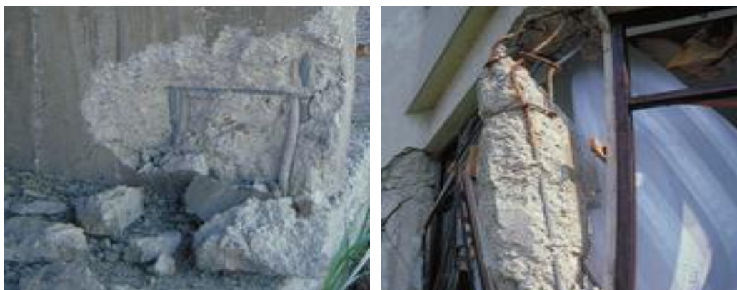
Figure II.12 : Flambage de l'armature longitudinale à la base de voile et dans les colonnes
