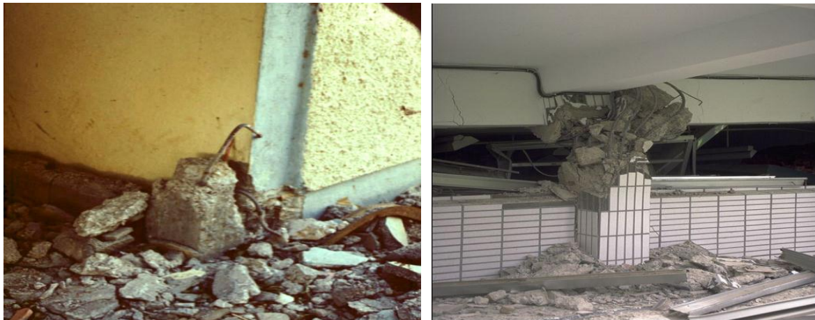
Figure II.9 : Dommages dus à l'effet de poteau court en vide sanitaire et dû à la présence d'allèges en maçonnerie dans la structure principale en portiques
