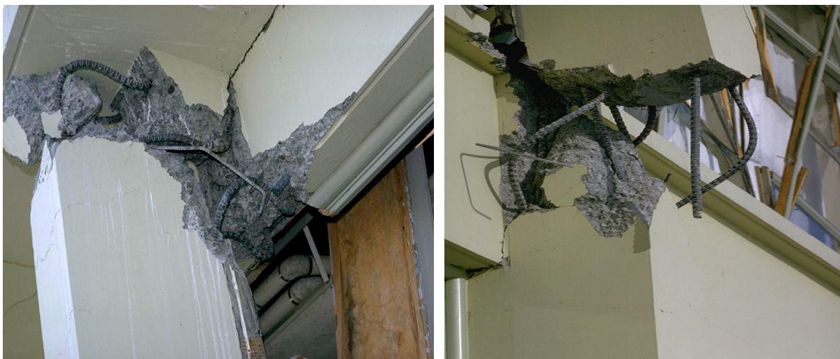
Figure II.1 : Eclatement de zones critiques (extrémités des poteaux et poutres)
