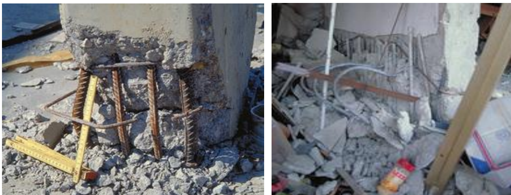
Figure II.11 : Ancrage déficient de l'armature transversale et recouvrement dans les zones sensibles
