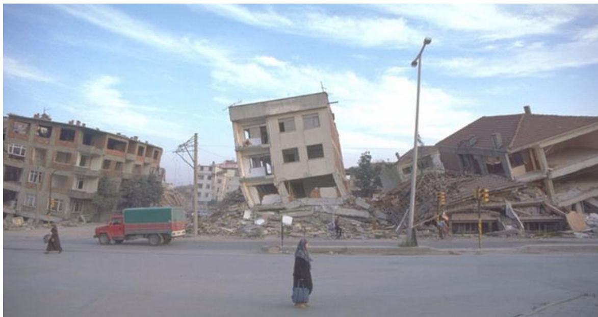
Figure II.13 : Martèlement et effondrement
