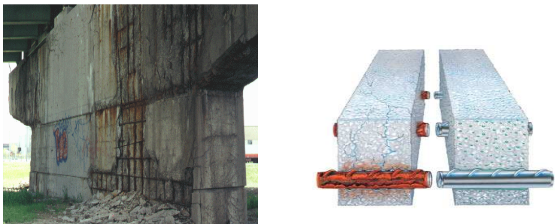
Figure (1.16) : agression du béton par activité des chlorures [44].
