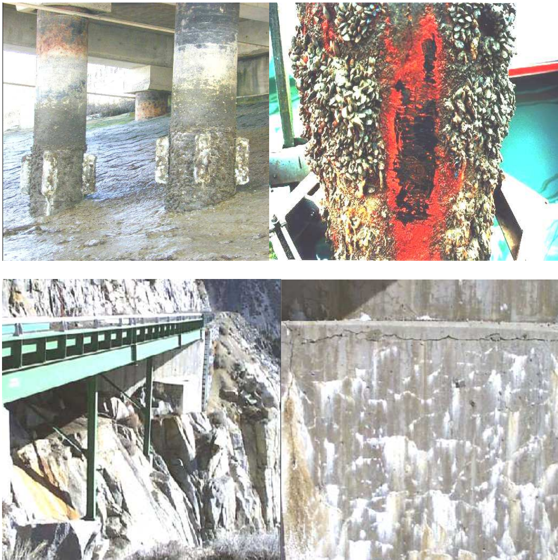
Fig. (1.7) : Des cas pathologiques rencontrés : l'influence des eaux agressifs en contact La figure I.7 l'attaque sulfatique des pieux et pont, le premier élément de la construction qui en contacte des eaux agressives. Elle présente un état avancé.
