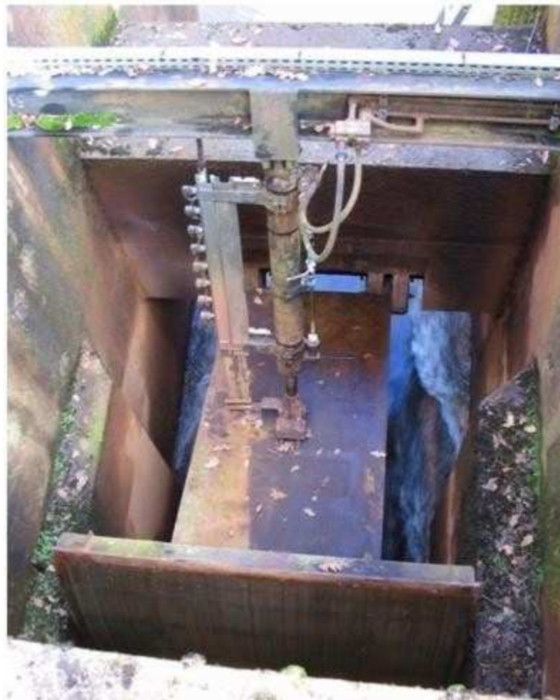
Figure I.18 : Vanne aval (vanne secteur).
