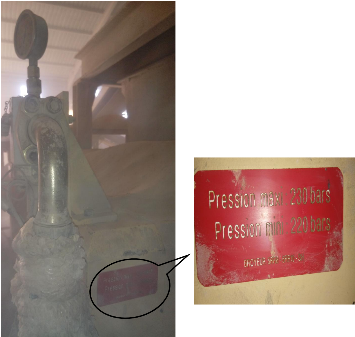
FIGURE (V-1) : Pression de service du broyeur 5RR10
