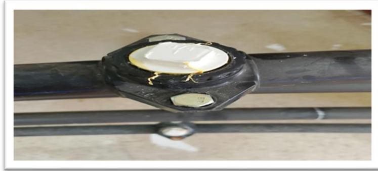
Figure III.10- Perforation de la conduite, afin de stimuler une fuite
