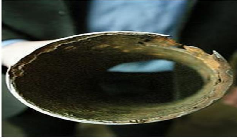
Figure I.8. Conduite ayant subi une rupture en Acier
