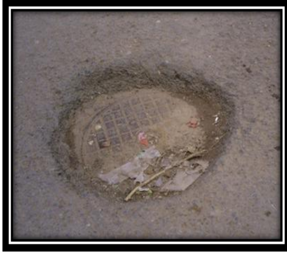
صورة رقم (13) مجمع للصرف الصحي
