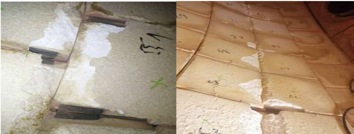
Figure IV-11 Dégradation des plaques céramiques.
