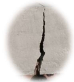
Figure 3. 8. Mode de fissuration et de rupture de la poutre fibrées sans ferrailage.
