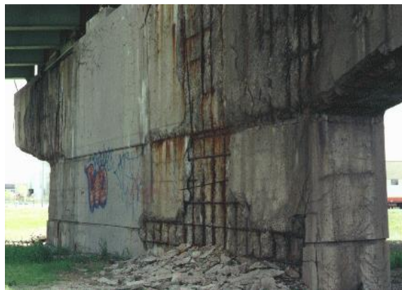
Figure II.8: agression du béton par activité des chlorures [68] [1] .
