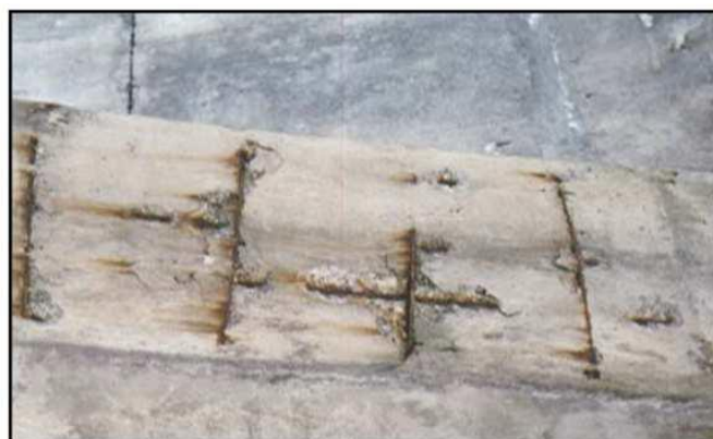
Figure II.12 : Carbonatation du béton et conséquences sur la structure [74].
