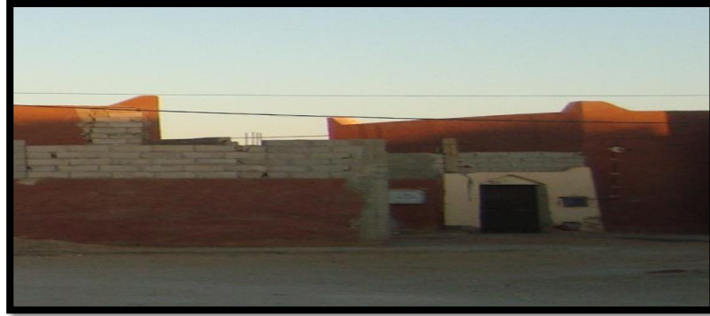
الصور (18): توضح حالة الواجهات في منطقة الدراسة من اعداد الطلبة 2014
