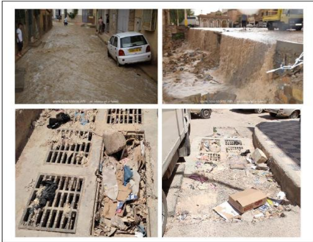
الصورة رقم (4): خطر الفيضان في احياء منطقة الدراسة
