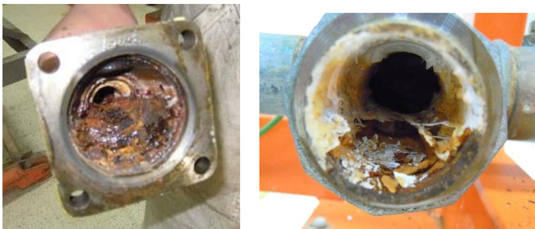
Figure II.51: Boîte d'échangeur et circuit bouché par le calcaire.
