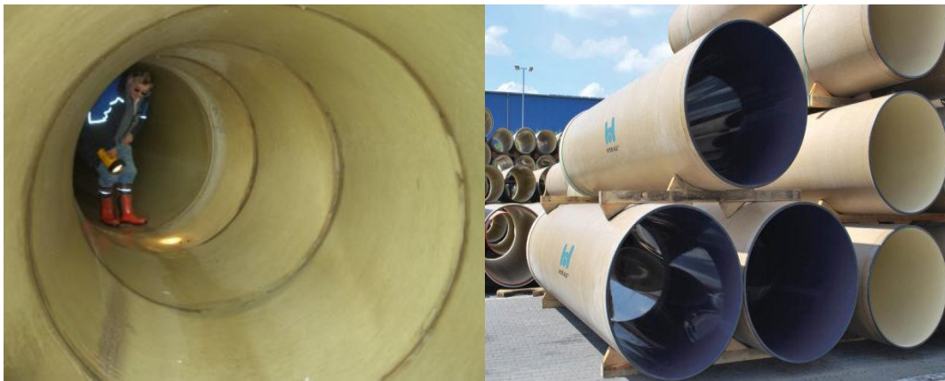
Fig I.9. Canalisations en PRV
