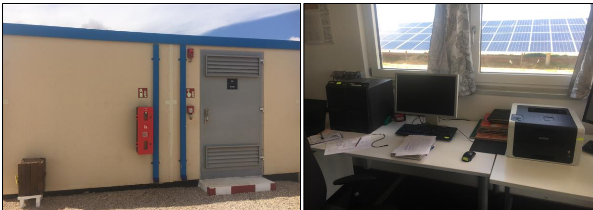
Figure II.6 : La salle de contrôle.
