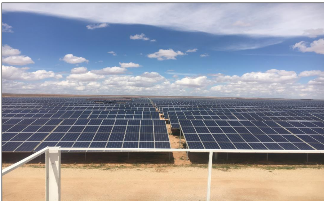
Figure II.2 : les champs photovoltaïques de la centrale d'Ain Skhouna.
