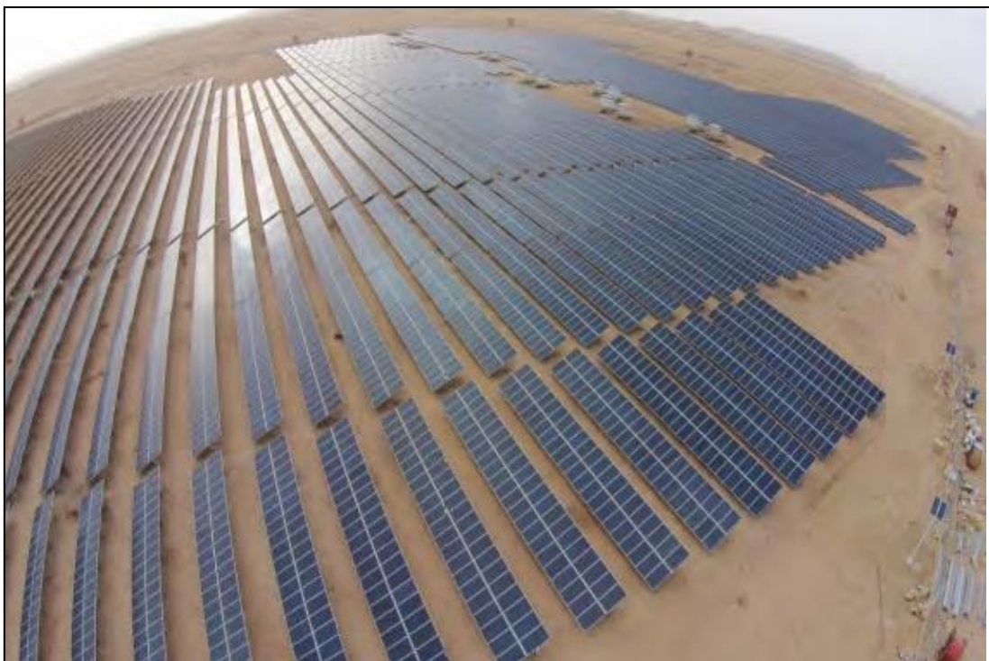
Figure I.3b : Centrale photovoltaïque de Tamanarasset 13 MWe [3].
