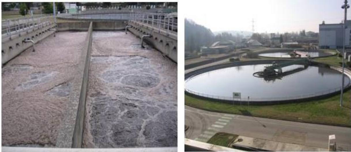
Figure .4. Bassin d'aération (à gauche) et les décanteurs secondaires (à droite)
