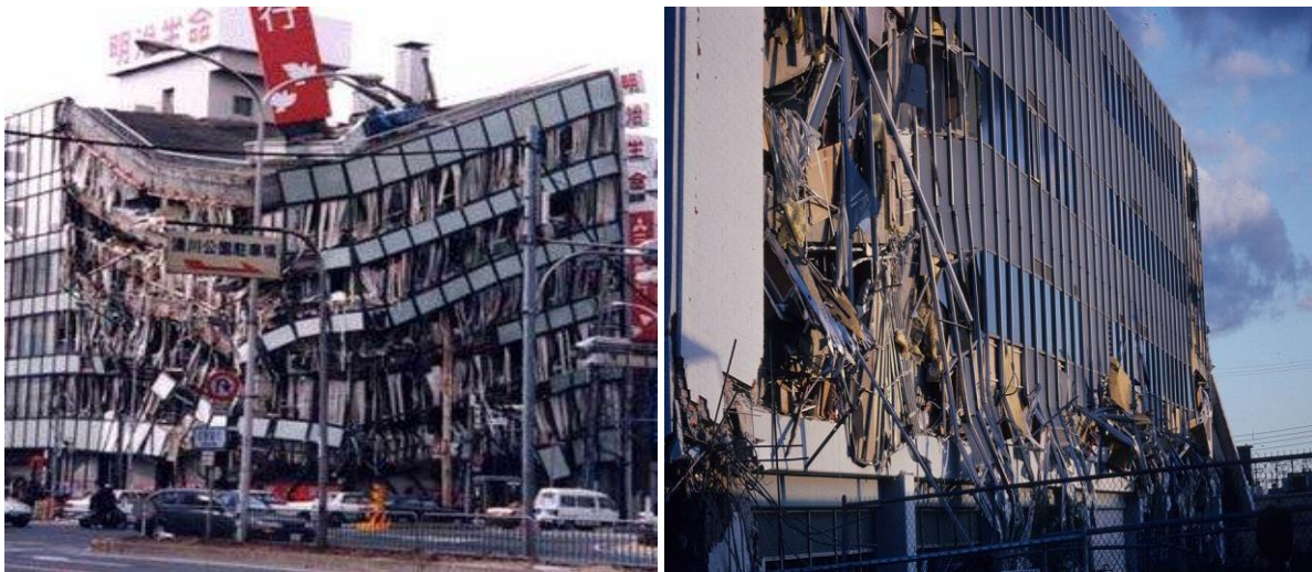
Fig.1.2. Bâtiments en acier effondrés lors d'un tremblement de terre [1].
