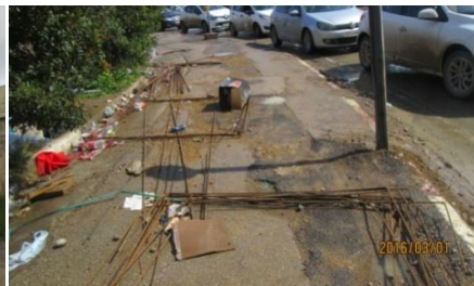
Photo N°48 : état de trottoirs dégradé ; carrefour les 300 logt
