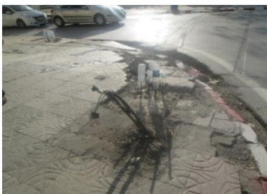
Photo N°80 : absence de luminaire
