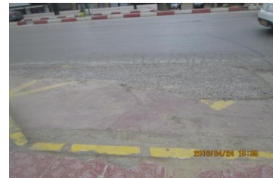
Photo N°69 : marquage d'un arrêt de bus (ligne en zigzag jaune) effacé
