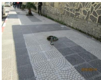
Photo N°81 : absence de luminaire
