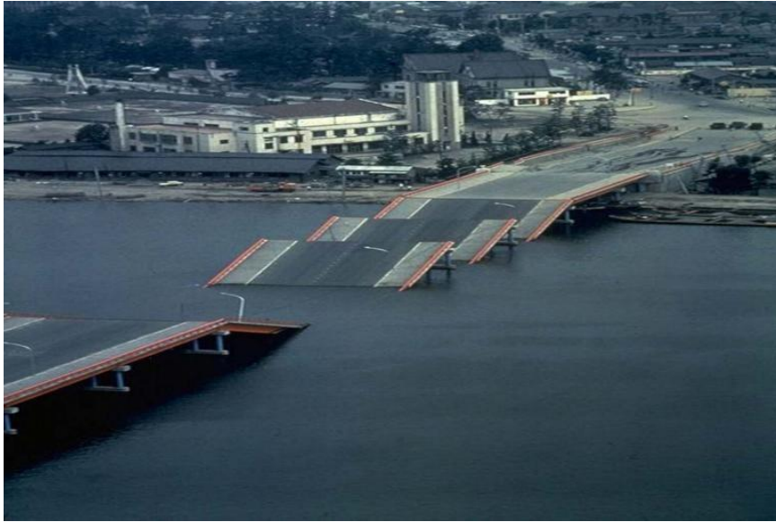
Figure 1.11 : Rupture du pont de Showa, à Niigata au Japon, dues à l' épannage latéral dans le sol (d' après Peter M. Byrne et al, 2008).
