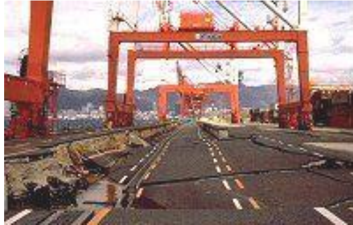
Figure 1.16 : Glissement de murs de quai : Lorsque le sol derrière et/ou sous un tel mur se liquéfie, la pression qu'il exerce sur le mur augmente considérablement et fait glisser ou/et incliner celui-ci, (d'après Alisha Kaplan, 2004)
