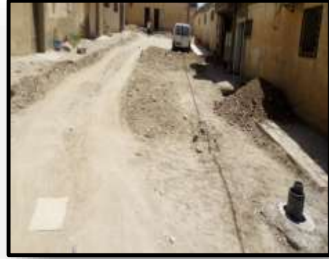
الصورة رقم 21: طريق في قيد الصيانة
