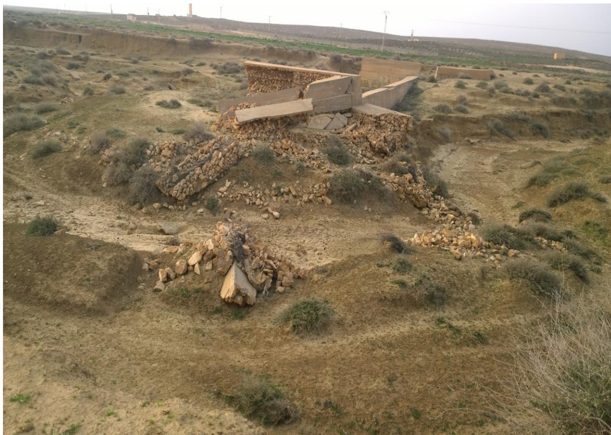
Figure(III.8) déplacement d'une grande partie du mur de soutènement due au crues
