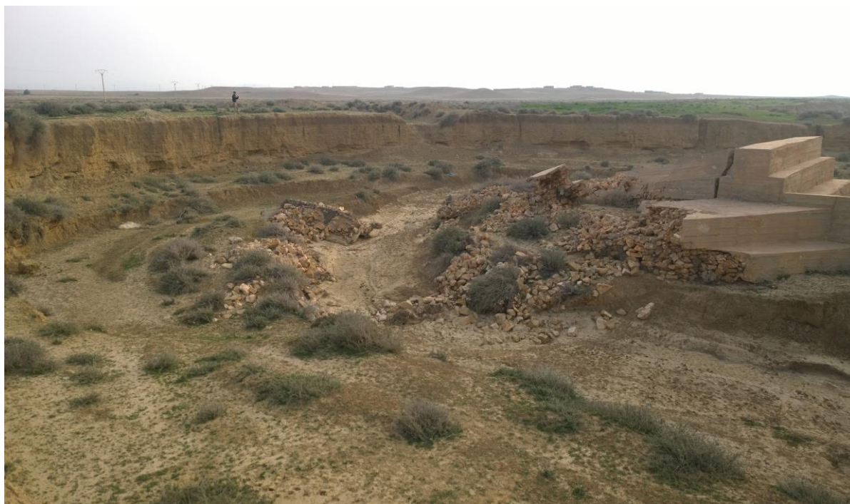
Figure (III.9) Etat de rive nord de digue après la crue
