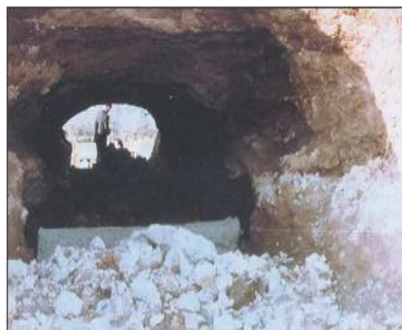
Figure (I.13) Renard dans un Barrage: (Lautrin; 2002)
