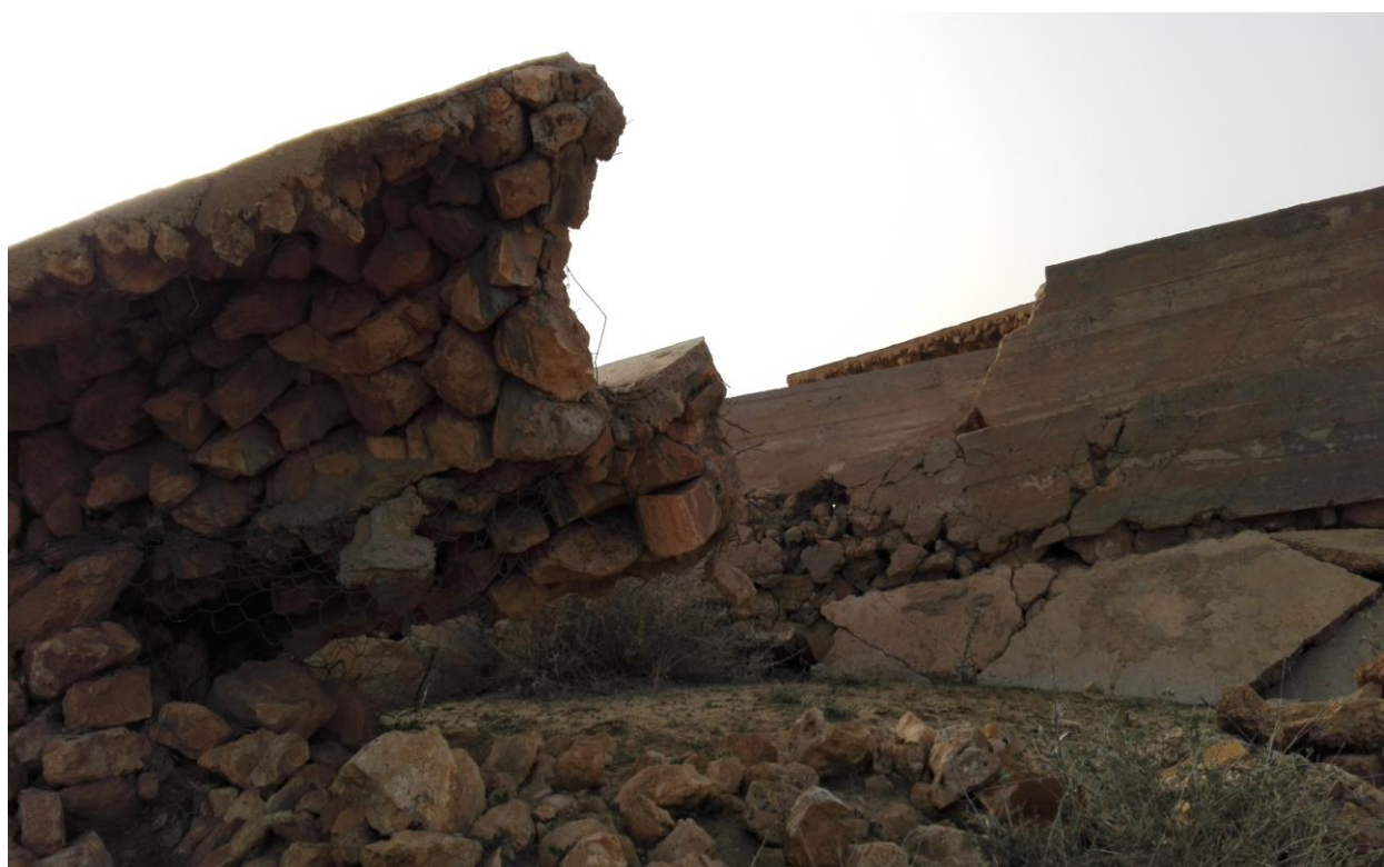
Figure (III.10) Scène montre l'absence le renforcement sur le béton armé
