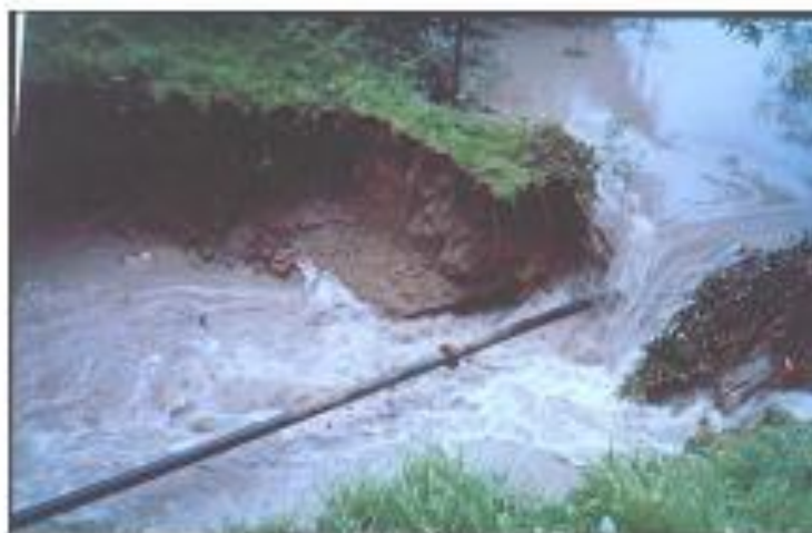
Figure(I.8) Renard autour d'une canalisation traversant la digue
