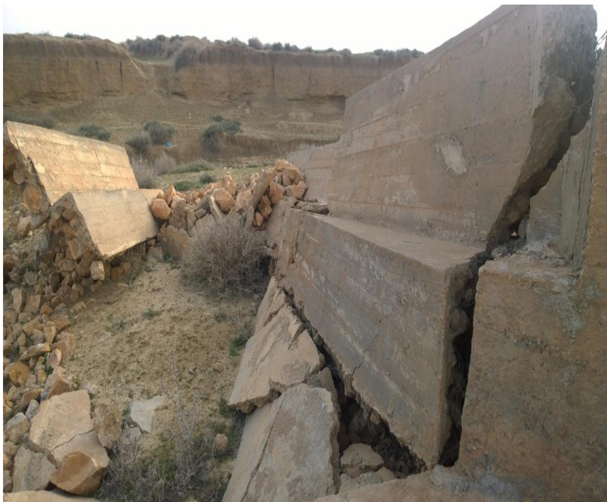
Figure(III.3) Le mur du barrage nord fissuré et décalé vers le bas après les inondations
