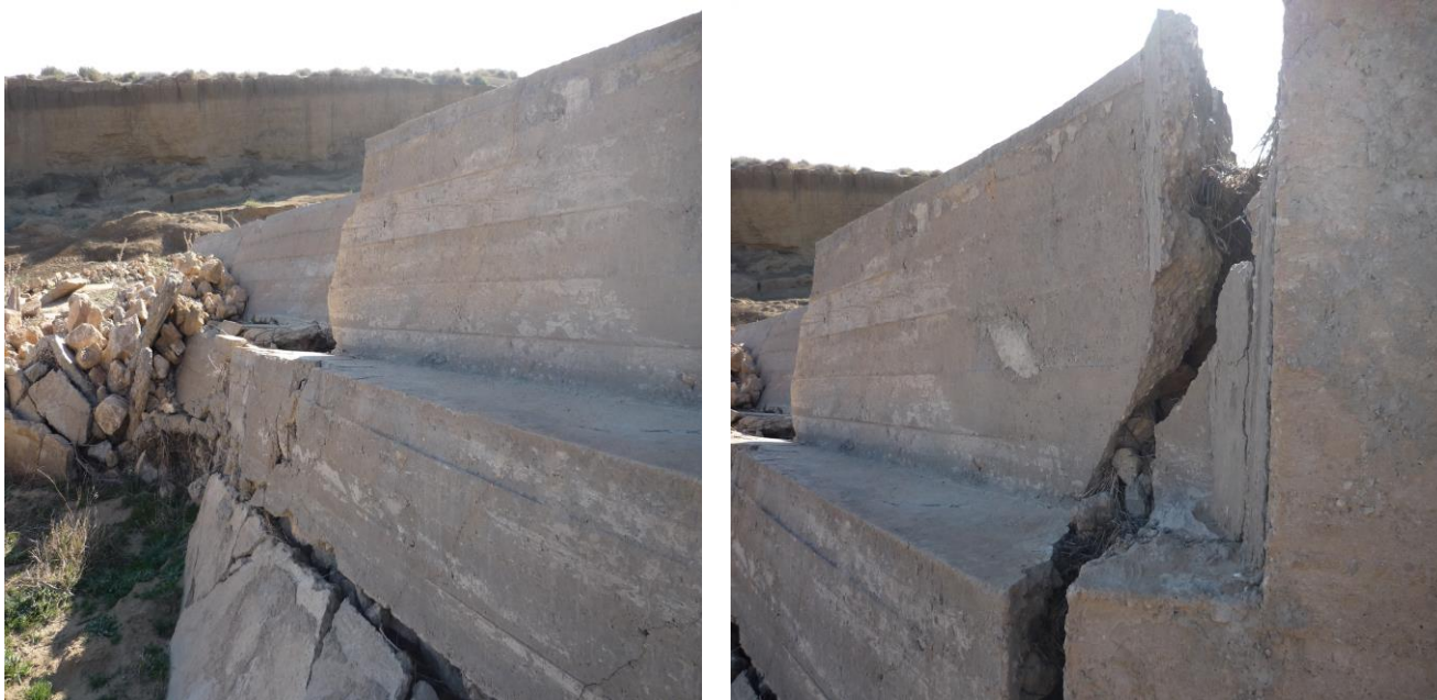
Figure(III.4) Le mur du barrage nord fissuré et décalé vers le bas après les inondations
