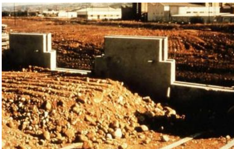
Figure 1.6 mur en terre armée [12].
