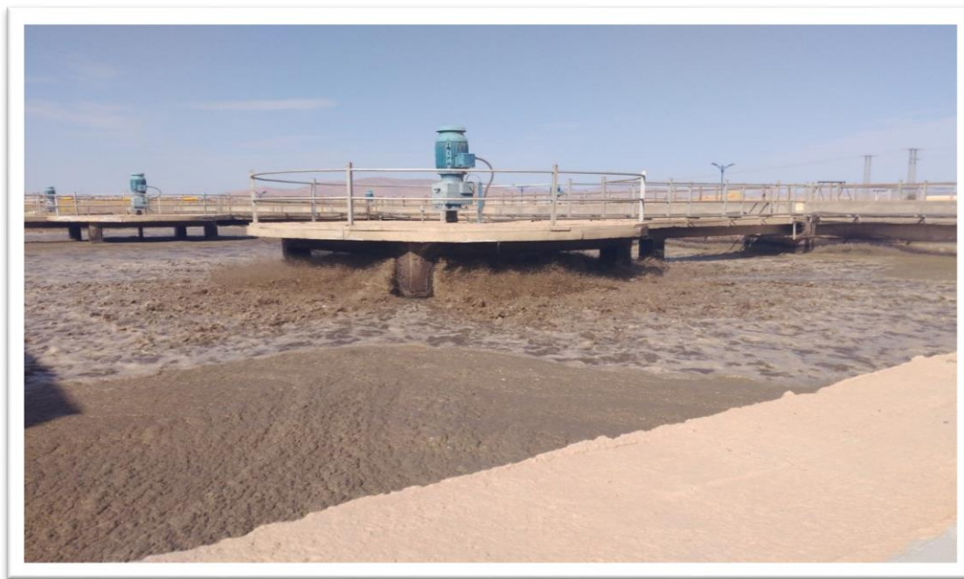
Photo II-5 : Bassin d'aération de la STEP de Sidi Aissa
