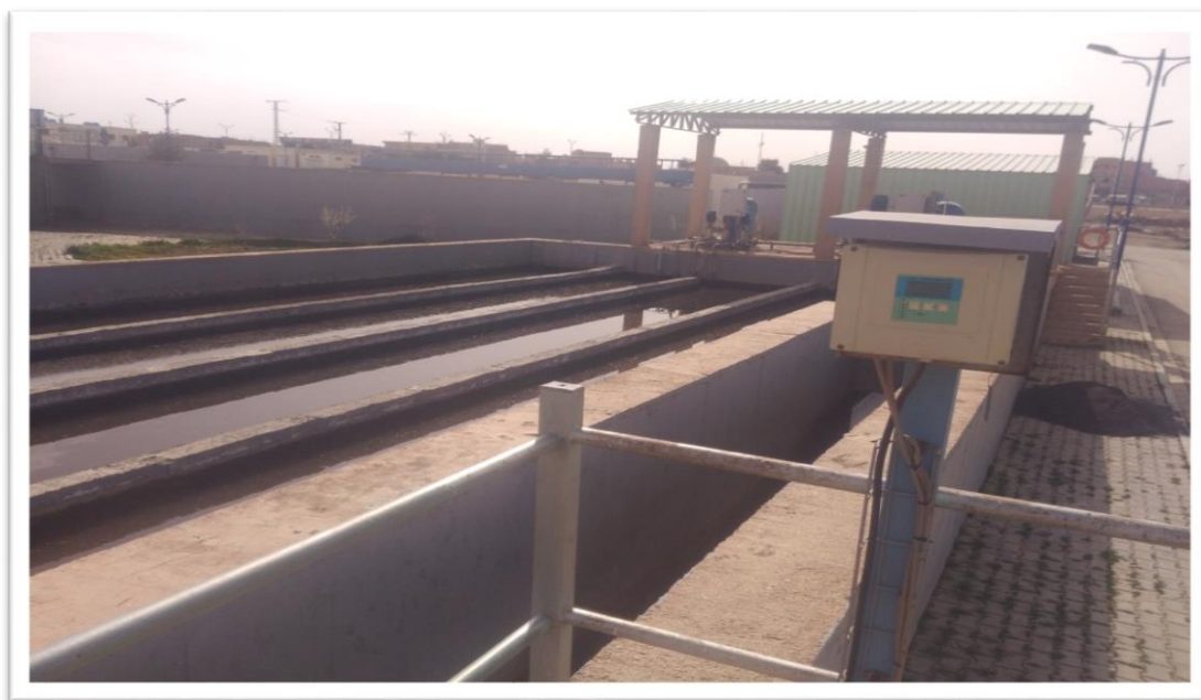
Photo II-7 : Bassin de chloration de la STEP de Sidi Aissa
