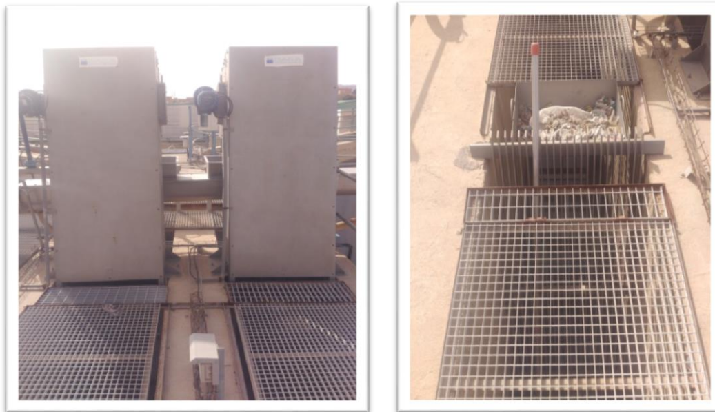
Photo II-3: Dégrilleur fin de la STEP de Sidi Aissa
