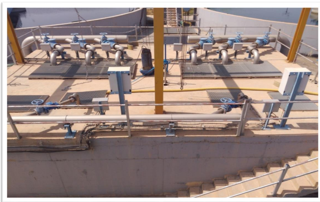
Photo II-8: Poste de recirculation de la STEP de Sidi Aissa
