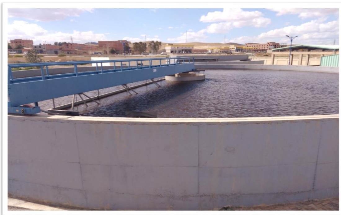
Photo II-6 : Décanteurs secondaires de la STEP de Sidi Aissa
