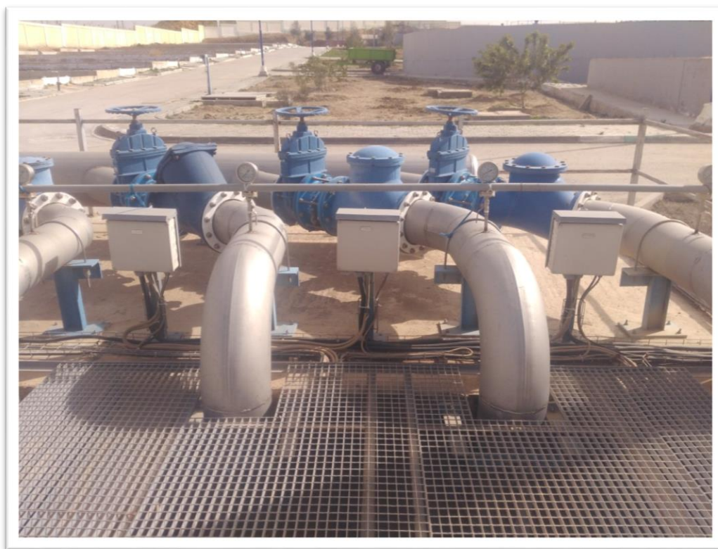
Photo II-2: La station de relevage de la STEP de Sidi Aissa
