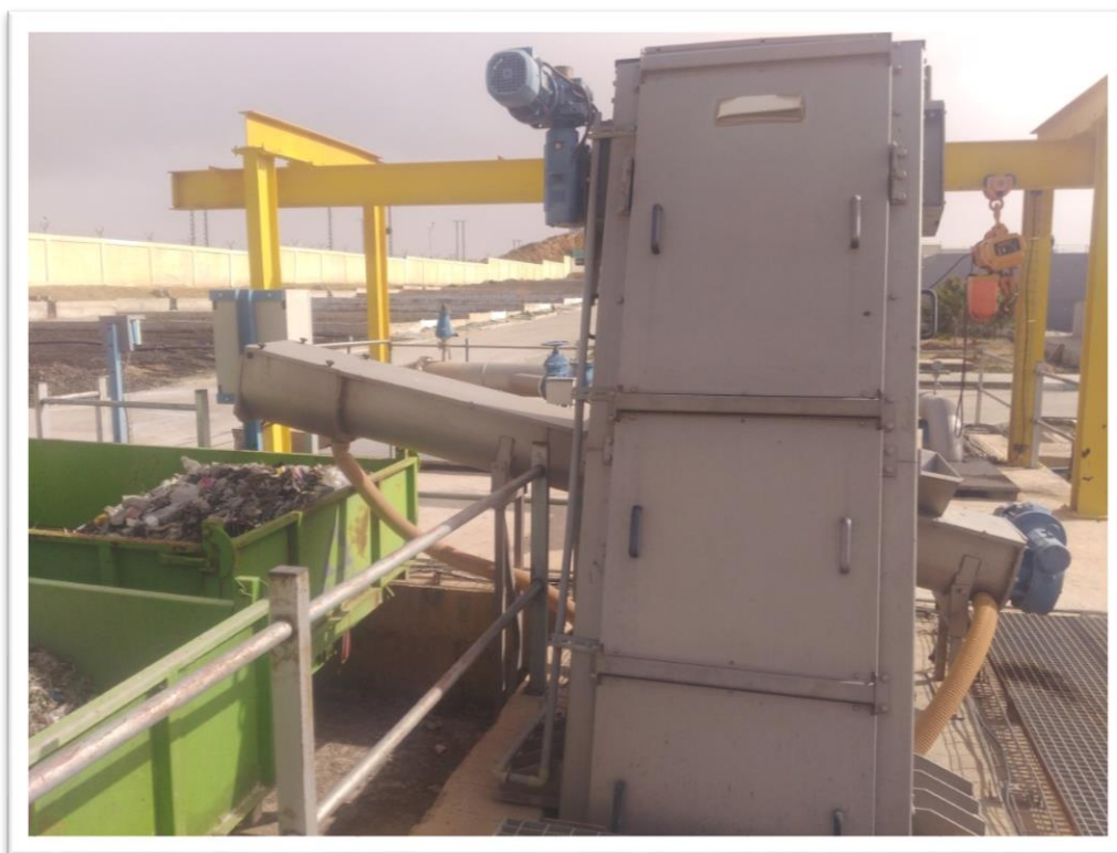
Photo II-1 : Dégrilleur grossier de la STEP de Sidi Aissa
