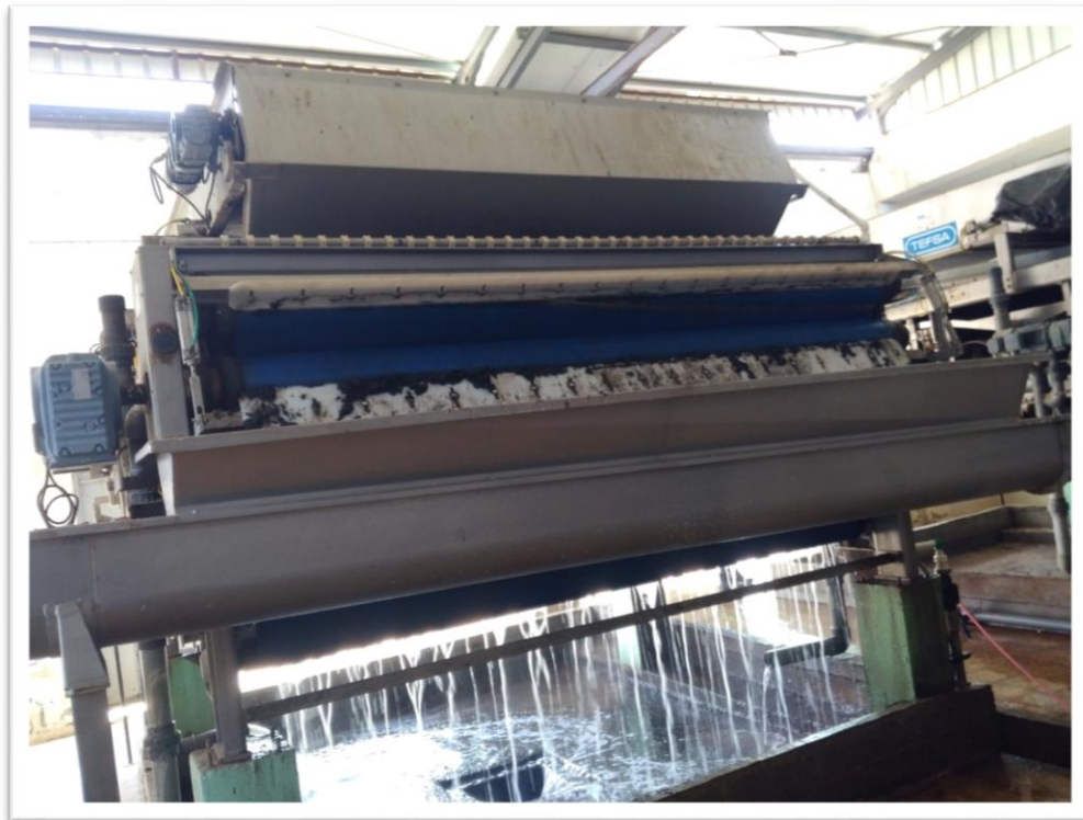
Photo II-11 : déshydratation mécanique de la STEP de Sidi Aissa
