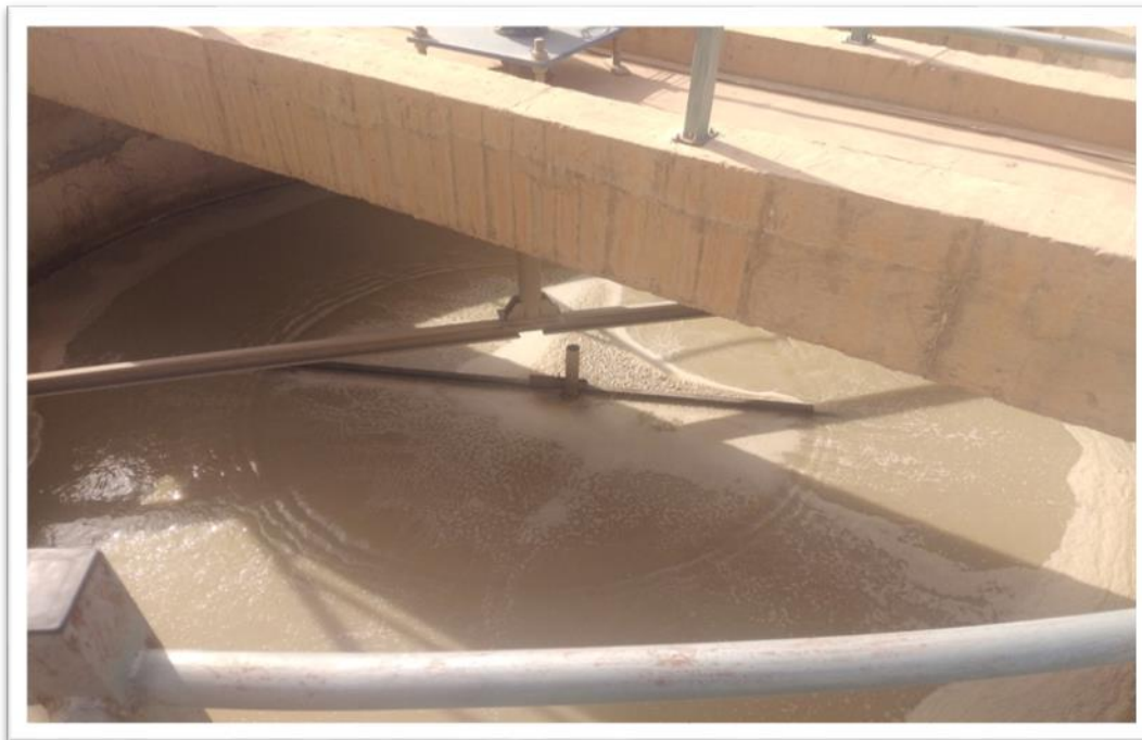
Photo II-4 : Dessableur-dégraisseur de la STEP de Sidi Aissa
