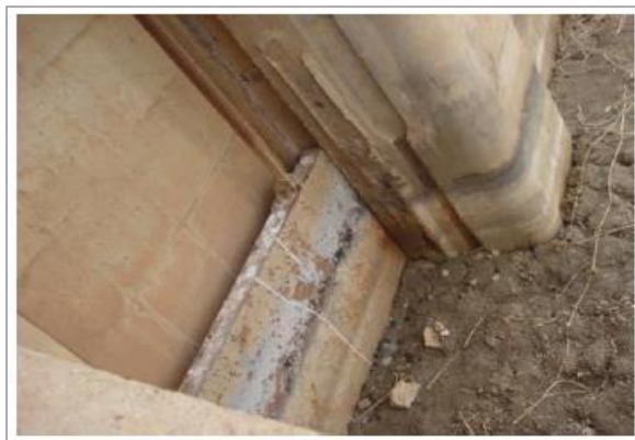
Figure 2.3. Blocage de la vanne de fond de la deuxième digue du barrage Boughezoul [28]
