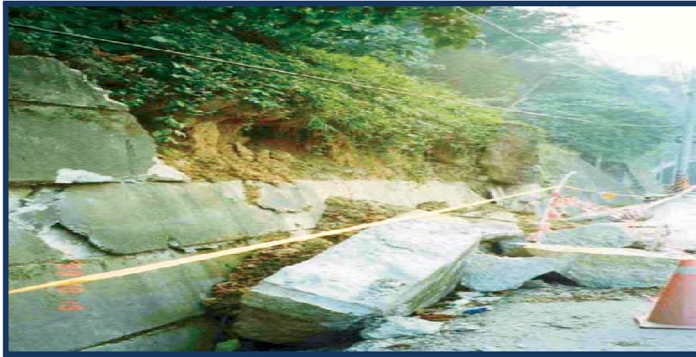
Figure 2 : Déplacement des couches supérieures du remblai le long des joints de construction en raison de la résistance de frottement insatisfaisante à la partie supérieure du mur (sèisme de Chi-Chi Taiwan (1999)).
