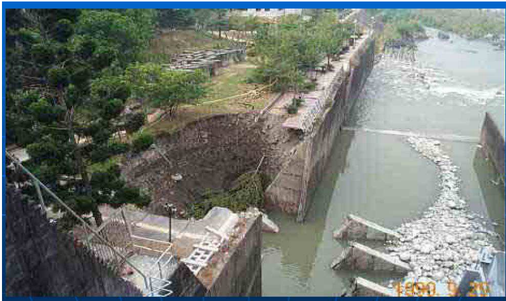
Figure 1 : Rupture par renversement d'un mur de soutènement, pendant le séisme de Chi-Chi Taiwan (1990).
