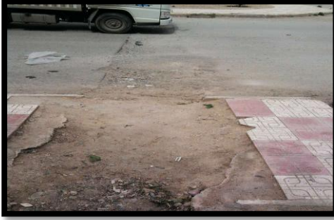
الصورة رقم 25 حالة الطرقات المصدر : تصوير الطالب
