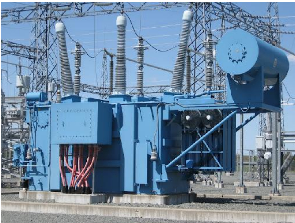
Figure II-10 : Transformateur de puissance
