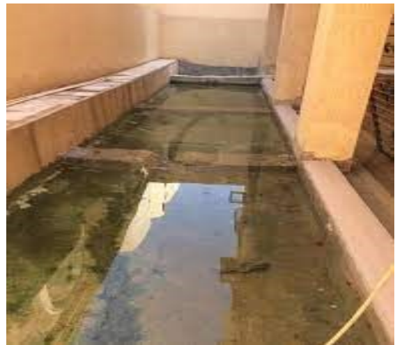
صورة 03: أرضية بناء مغمورة بالماء.
