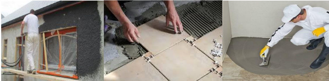
Figure I-2 : Application des mortiers industriels
