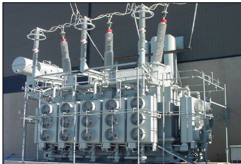
Figure (I-10) : Transformateur élévateur de sortie de centrale électrique
