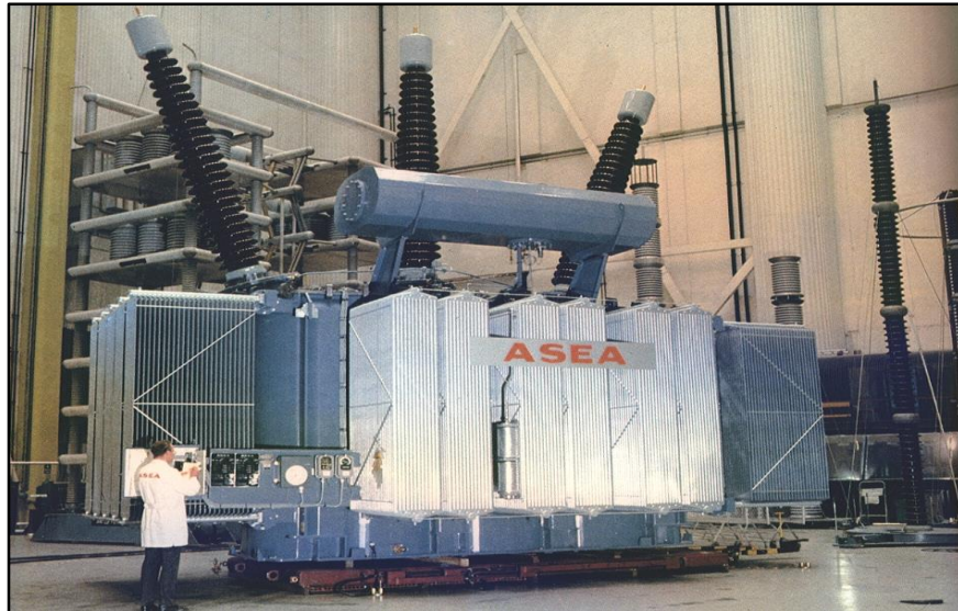
Figure (I-3) : Transformateur triphasé 250 MVA, 735 kV d 'Hydro-Québec
