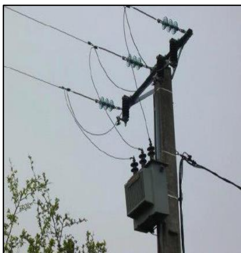
Figure (I-12) : Poste de distribution sur poteaux
