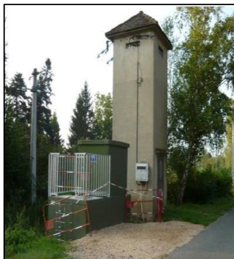
Figure (I-13) : Poste de distribution Cabiné
