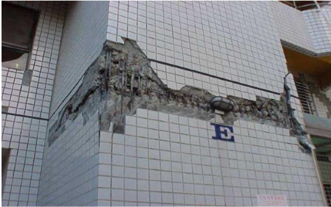
Figure II.12: ChiChi 1999 Fissure de cisaillement et rupture de l'enrobage au droit d'une reprise de bétonnage et d'une zone de recouvrement.
