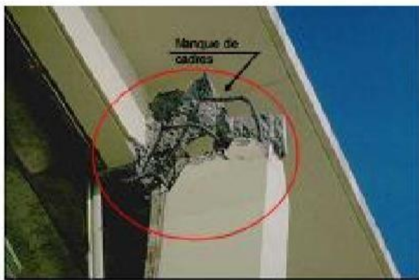
Figure II.6 : éclatement des noud par manque de frettage
