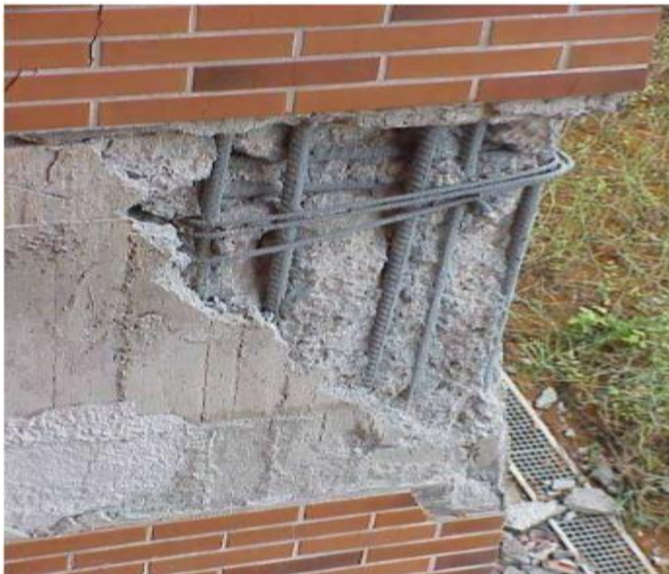
Figure II.11 : Dommage localisé à l'extrémité d'un voile, malgré la pauvreté du confinement
