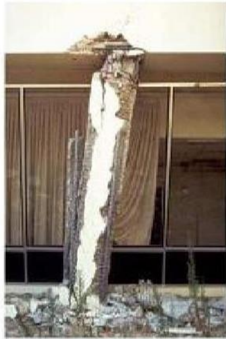
Figure II.5 : disposition incorrecte des cadres
