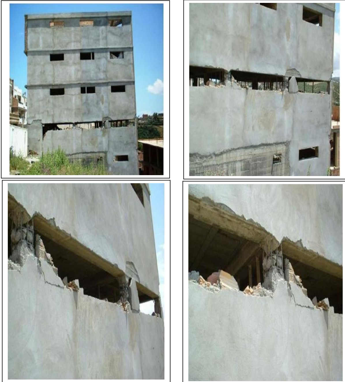
Figure III.10: Éclatement des nœuds, désolidarisation du poteau d'angle de la structure
