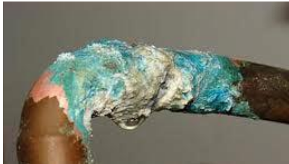
Figure (1.4) Produits de corrosion du cuivre [13].
