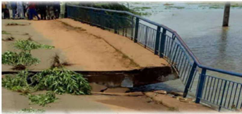
Figure I.1 : L'affaissement du pont de Malan ville, Septembre dernier, a mis en péril le trafic entre le Bénin et le Niger.
