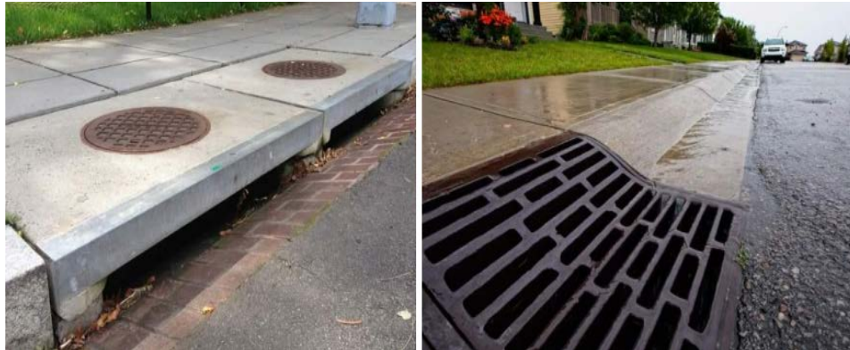
Figure VI.3: Les bouches d'égout
