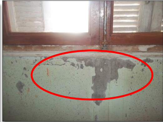
صورة رقم (3) : رداءة مواد البناء
