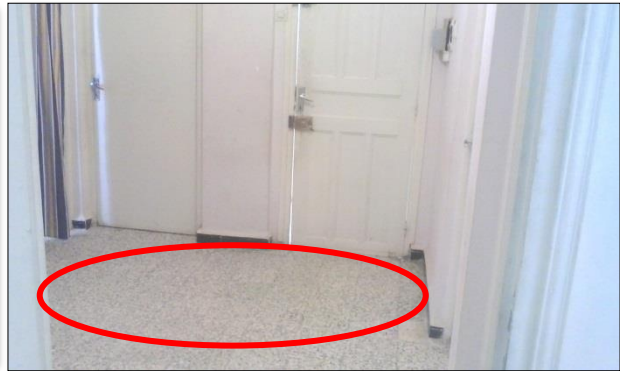
صورة رقم (19) : رداءة مواد البناء
