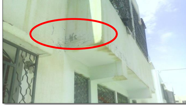
الصورة رقم (2) : وجود تسربات بالمسكن
