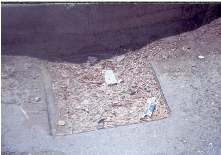
Fig. III.4 Bouche d'égout complètement bouchée
