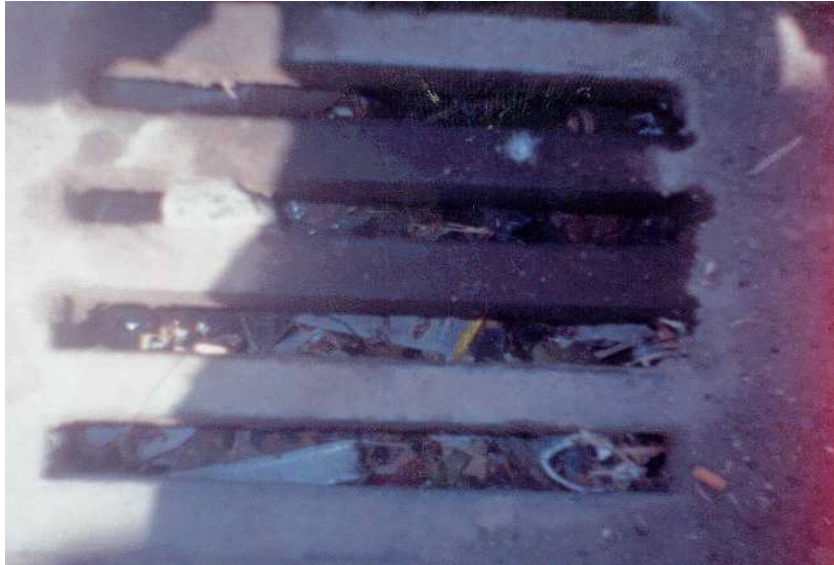
Fig. III.3 Bouche d'égout non nettoyée
