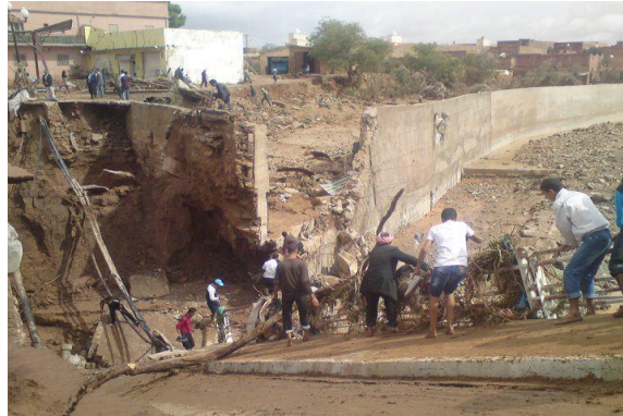
الصورة 30: جسر عين المهولة بعد فيضانات 2011
