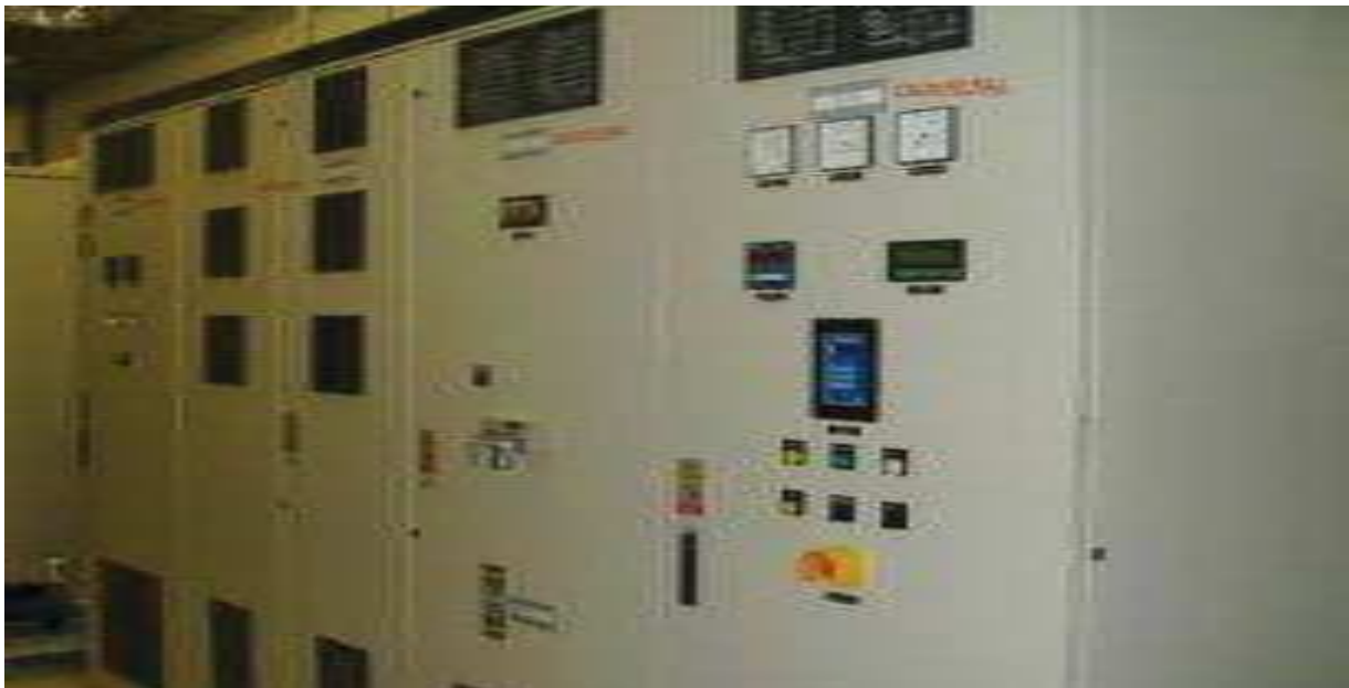
Figure III-23: Les blocs de variateurs
