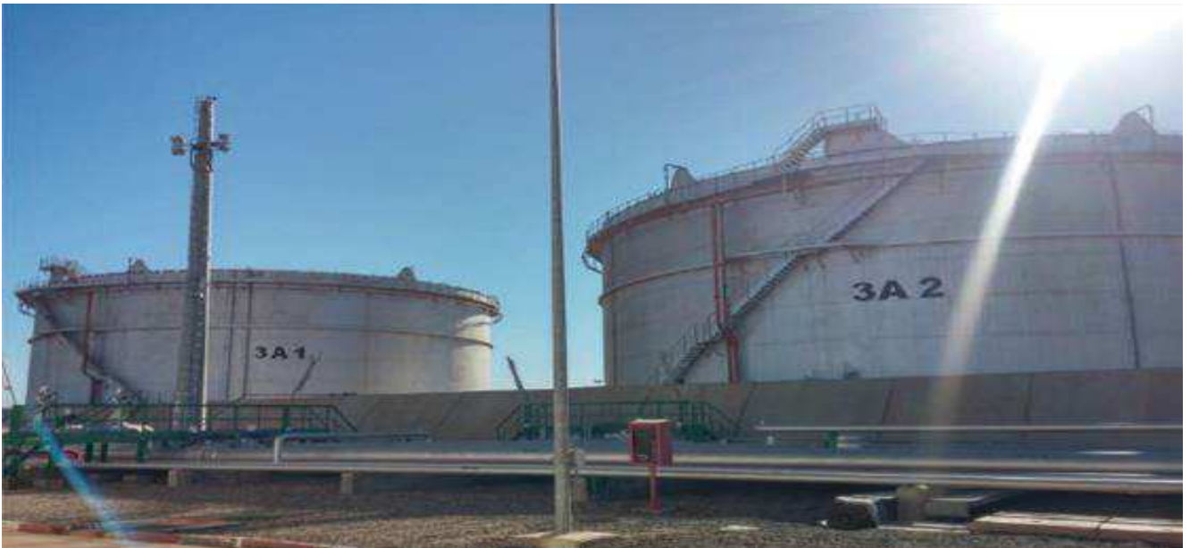
Figure III-13: Réservoirs de stockage tampons 3A1- 3A2
