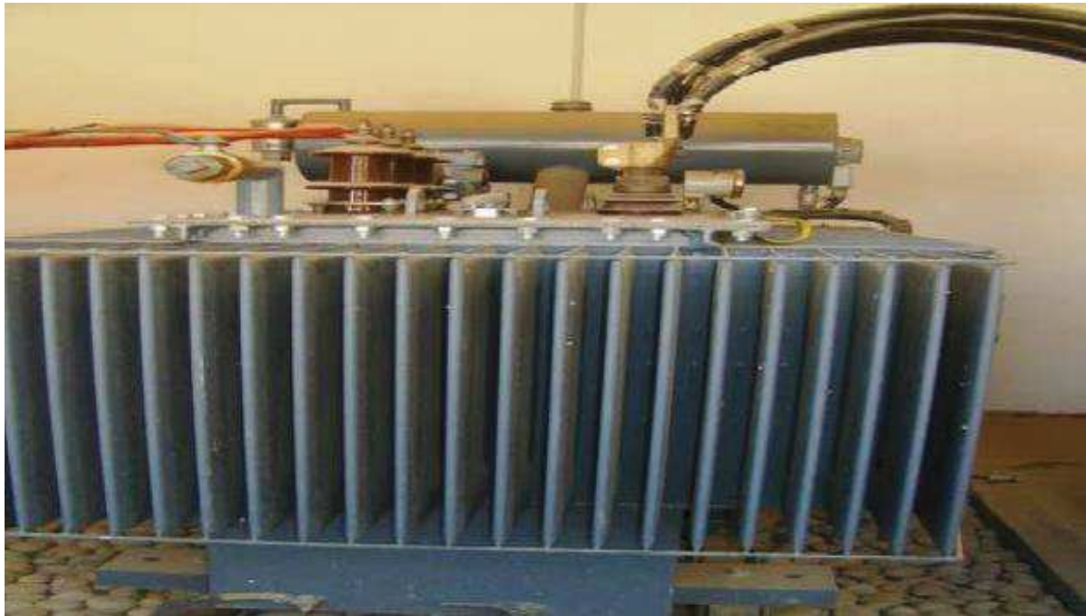
Figure III-24: Les transformateurs électrique MT/BT 5,5 KV/230-400 V
