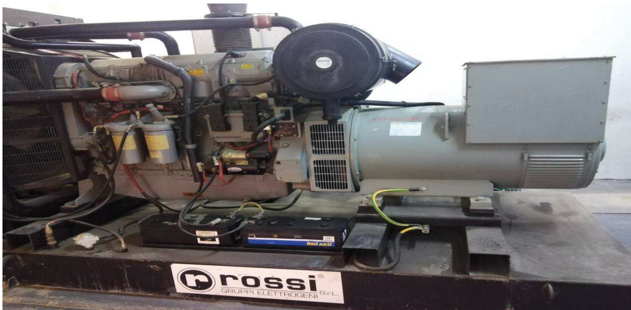
Figure III-25: Groupe de secours (Groupe électrogène)
