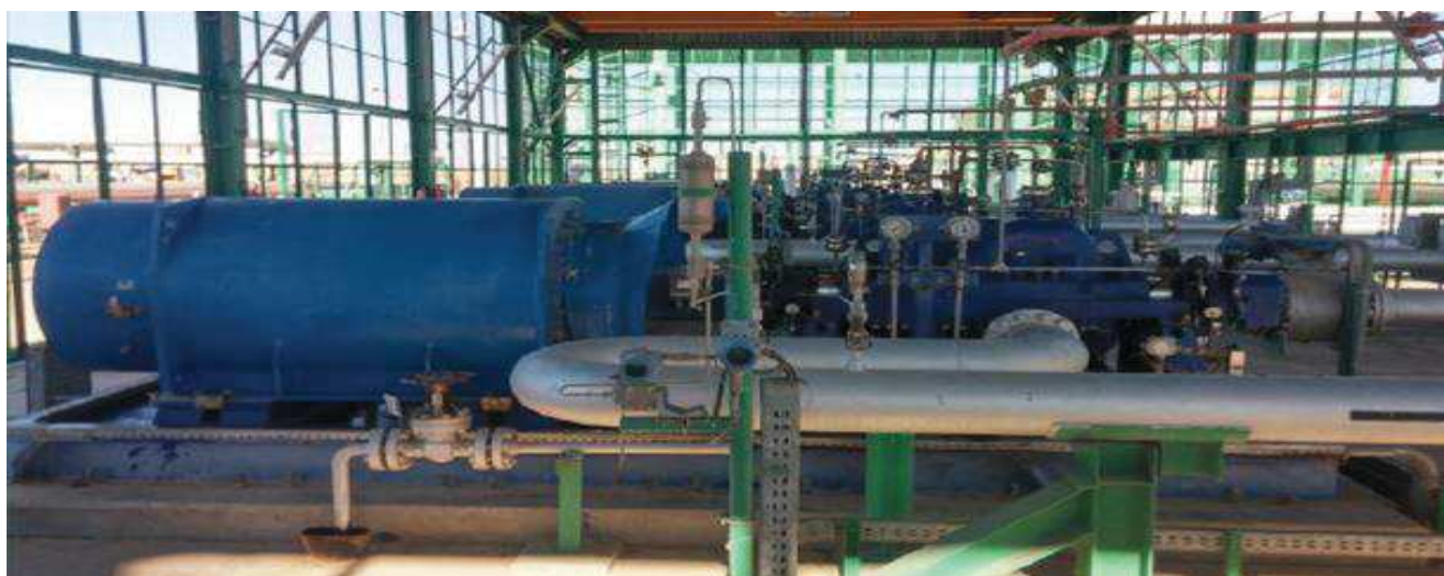
Figure III-15: Les Groupe électropompes principale (GEP).
