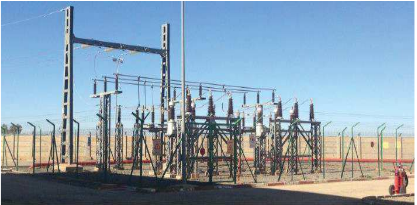
Figure III-20: La ligne électrique haute tension de 60 kV
