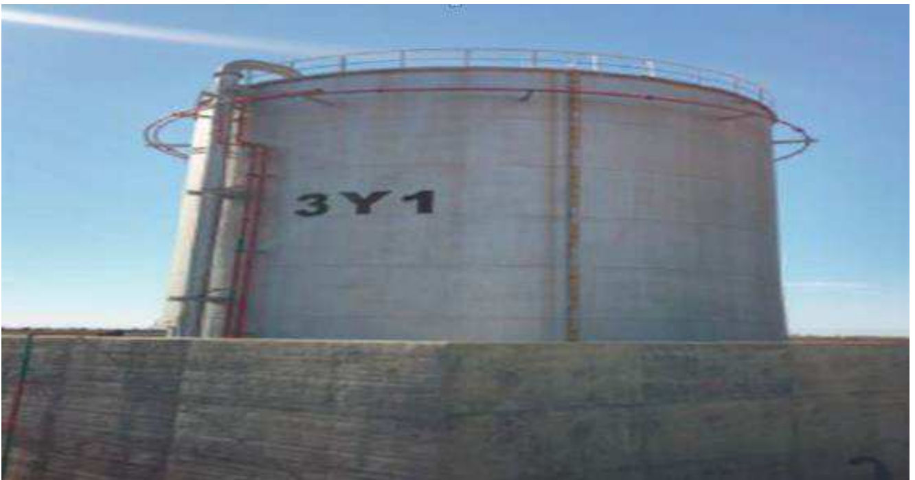
Figure III-17 : Réservoir de décantation 3Y1
