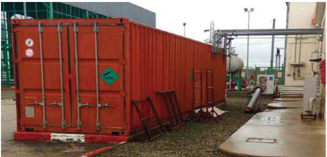
Figure III-6: système d'extinction au CO2
