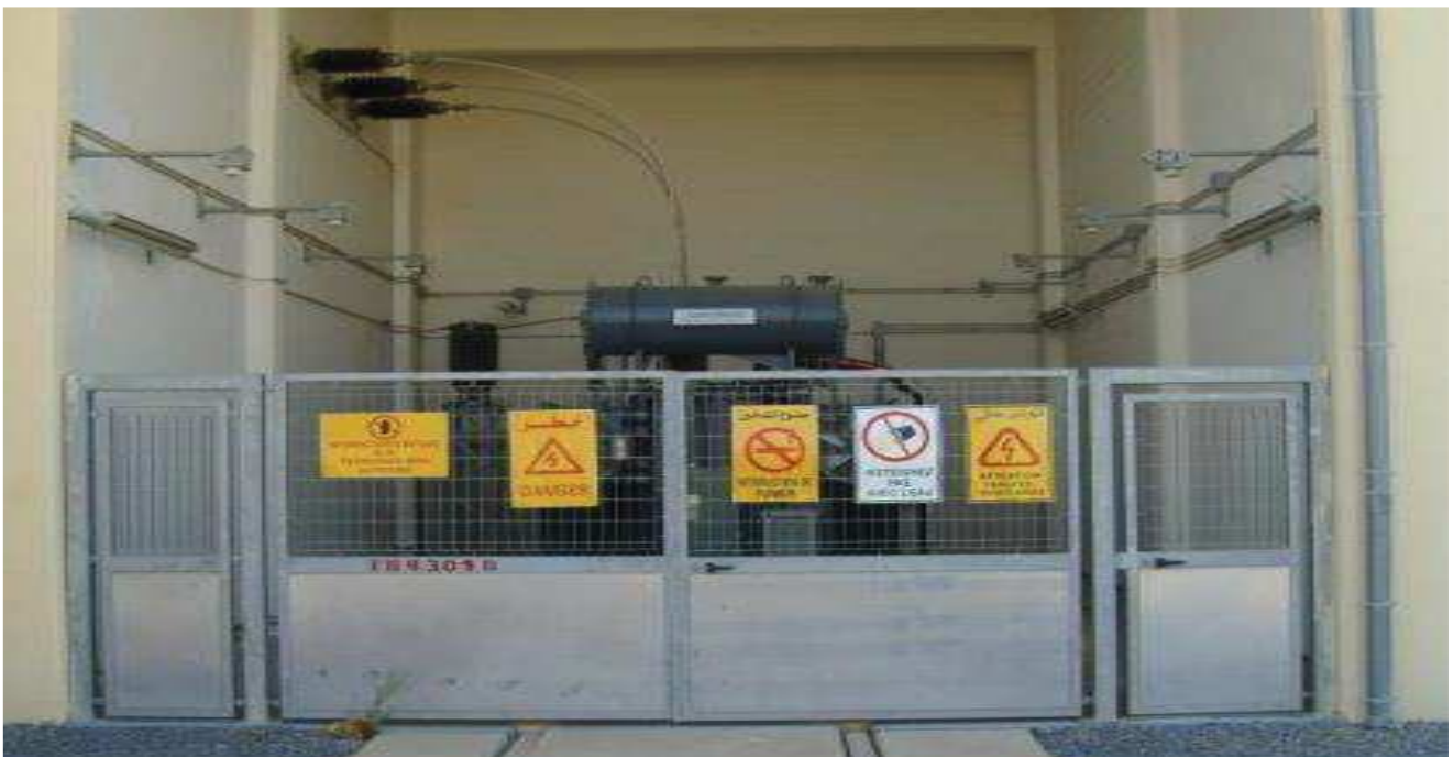
Figure III-21: Les transformateurs HT –MT 60 KV/5,5 KV
