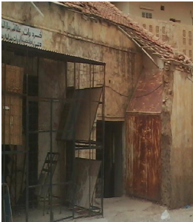
الصورة رقم 17: اهتراء الأبنية.
