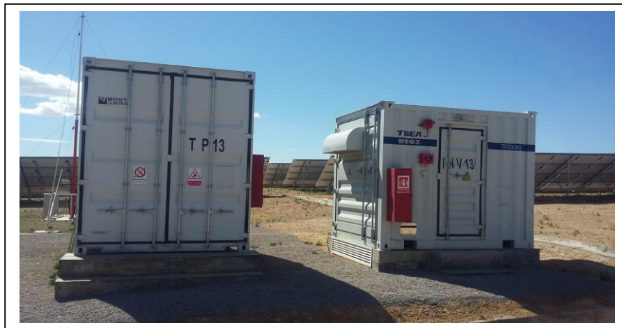
Figure IV.5. Salle de Transformateur.
