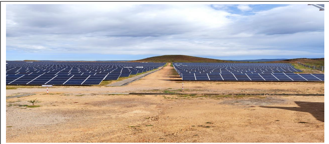
Figure IV.1. Centrale d'énergie solaire
