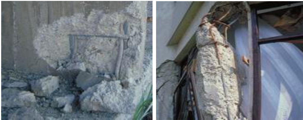
Figure II.12 : Flambage de l'armature longitudinale a la base de voile et dans les colonnes
