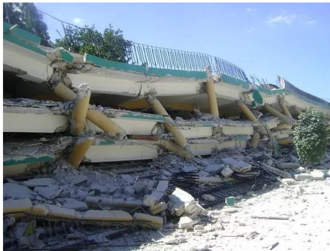
Figure II.10 : Effondrement en galette
