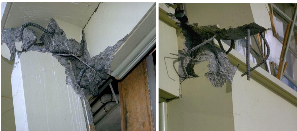
Figure II.2 : Eclatement de zones critiques (extrémités des poteaux et poutres)
